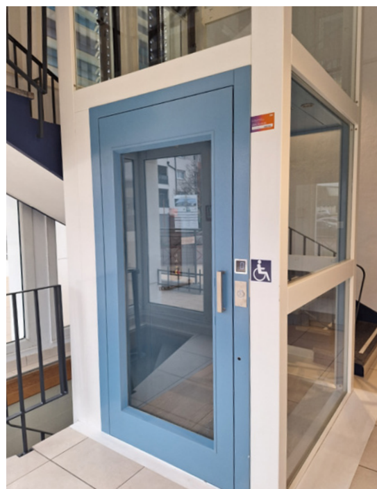
Un ascenseur pour garantir l'accès PMR
