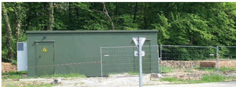
Nœud de raccordement optique
