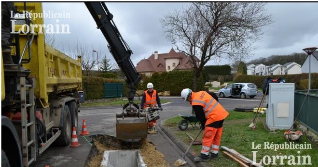
Photo HD la SOGEA procède actuellement à l'installation de boîtes de dérivation dans les routes. Photo RL
