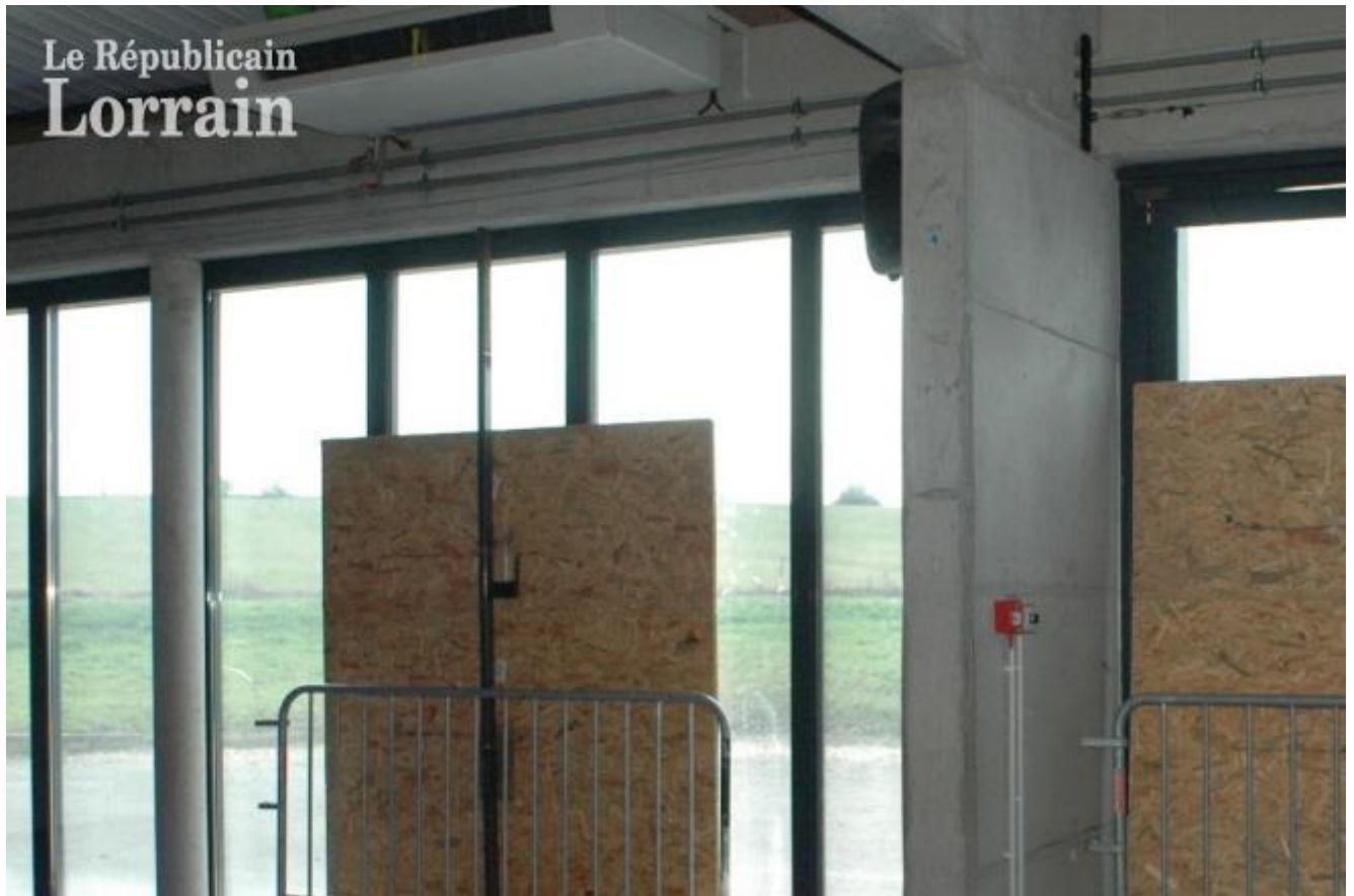
Photo HD Protection en attendant remplacement des vitres
