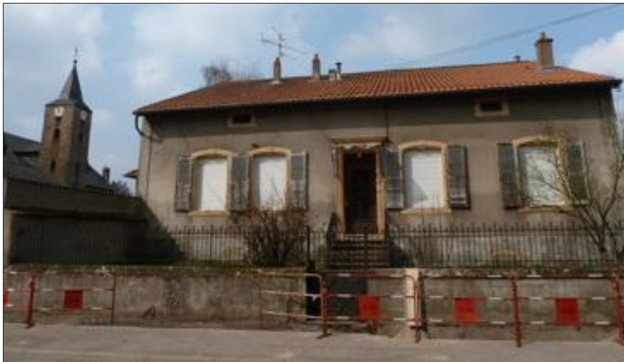
Une crèche bientôt dans le presbytère inoccupé et qui se dégrade ? Réponse sous peu ! Photo RL
